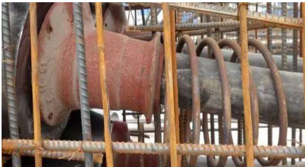
螺旋钢筋安装未贴紧锚垫板端部
